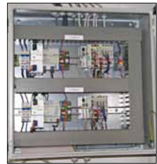
Elektroverteiler mit KNX IP Controller, KNX/TPI-Klemme und vier DALI-Mastern / Distribution cabinet with KNX IP controller, KNX/TPI module and four DALI masters
