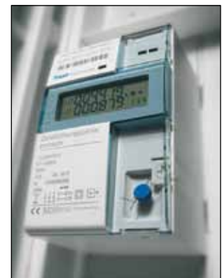
Der elektronische Haushaltszähler entspricht den neuen gesetzlichen Regelungen / This electronic household meter complies with the new legal requirements
