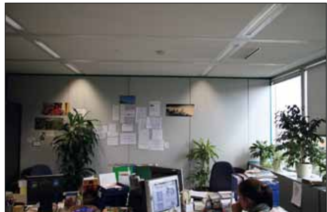
Tageslichtabhängige Beleuchtungssteuerung in den Büros / Lighting control depending on the level of daylight in offices
